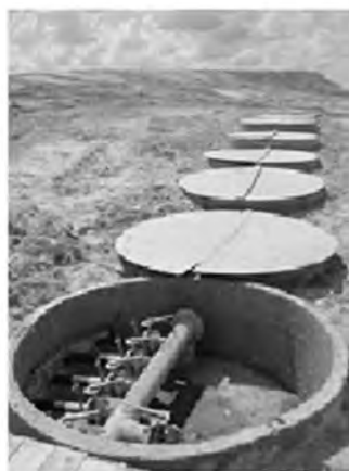
Рис.5. Ряд колекторів у бетонному колодязі.
