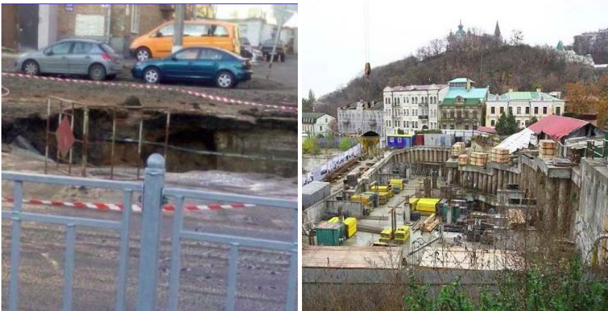
Рис. 2. Провал дороги в районі Севастопольської площі (м. Київ) [3]; незаконне будівництво в історичному центрі Києва руйнує пам'ятки архітектури [4]
