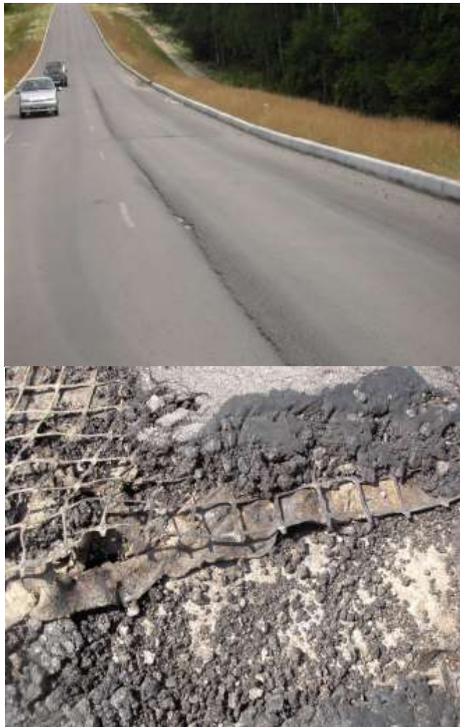
Рис. 2. Вигляд ділянки на спуску та руйнування асфальтобетонного покриття у верхній частині ділянки
