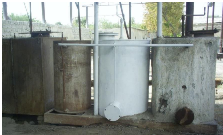
Рис. 3 – Общий вид опытно-производственной биогазовой установки
