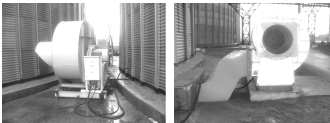
Рис. 4 – Підключення вентиляторів для активного вентиляції металевих силосів
