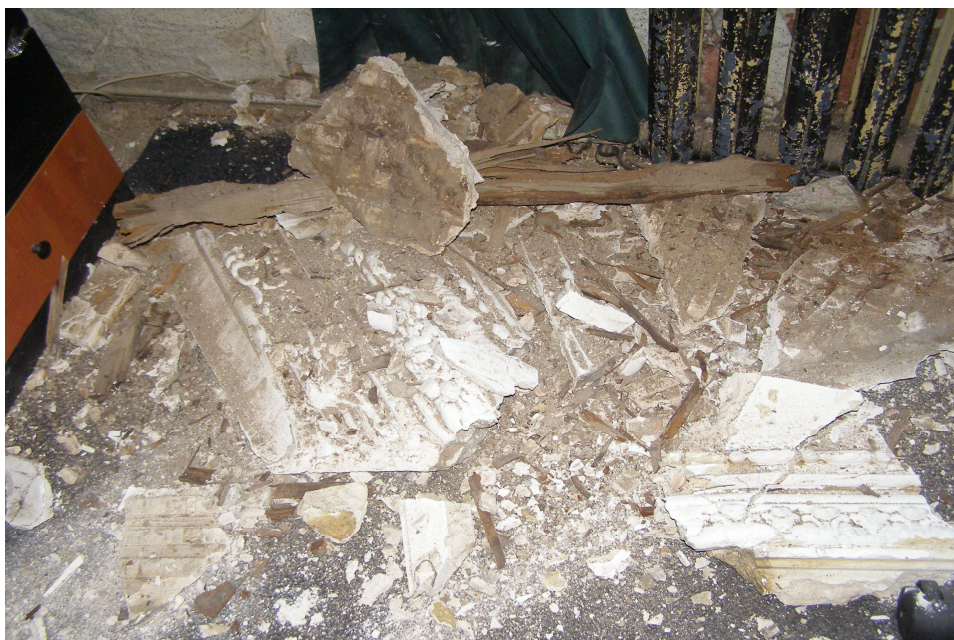
Мал. 2. Стан пам'ятки житлової архітектури місцевого значення – жилого будинку в м. Києві по вул. Велика Житомирська, 13 (вид зсередини; фото З. Копчинської)
