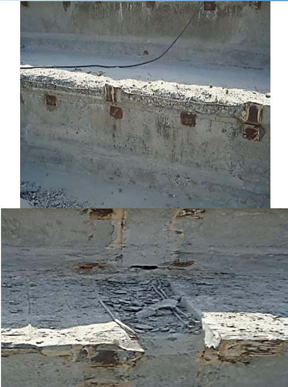
Рис. 1. Пошкодження залізобетонних конструкцій панелей-складок після їх очищення від нашарувань ремонтних розчинів
