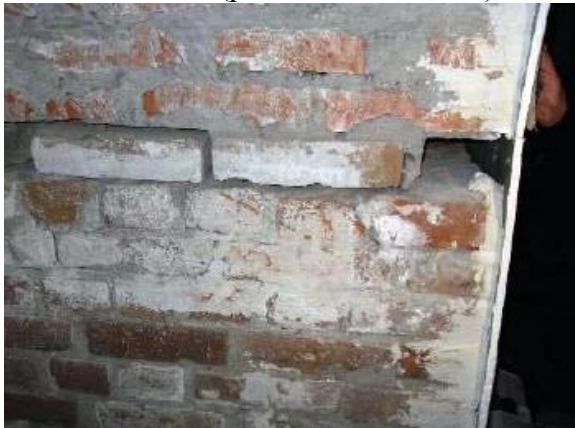
Рис. 6. Разрушение кладки грибком
