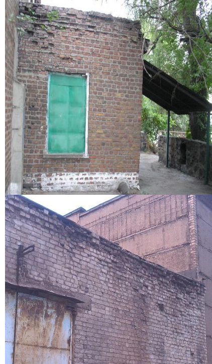
Рис. 1. Дефекти зовнішніх стін будівлі насосної станції
