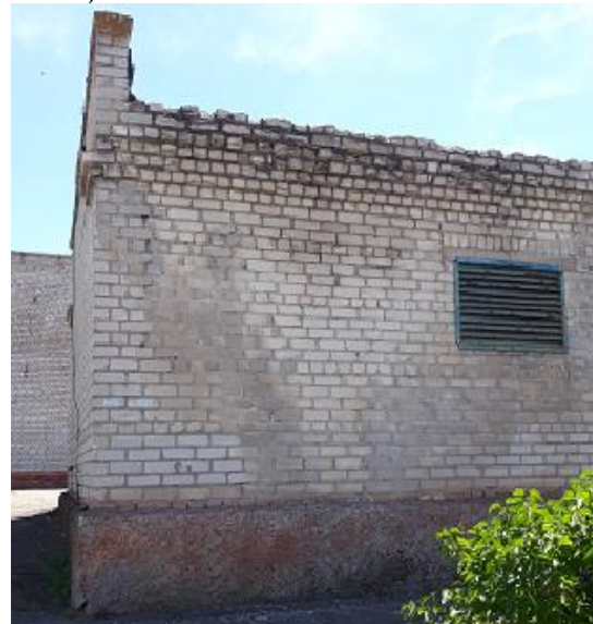
Рис. 2. Дефекти цегляних стін вентиляторної
