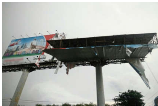
Рисунок 8 – Зруйнована верхня частина білборда
