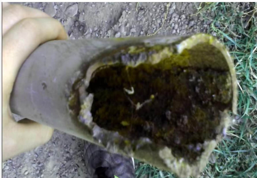
Рисунок 3 – Фрагмент водопровідної труби внутрішнього протипожежного водопостачання будинку
