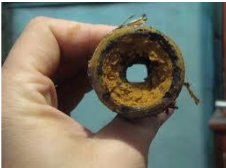
Рисунок 2 – Зріз водопровідної труби холодного питного водопостачання
