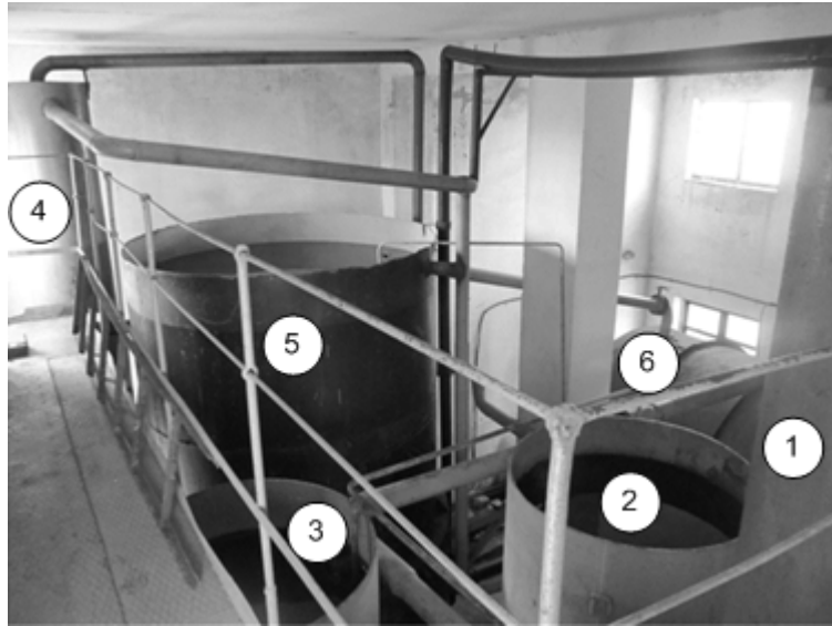
Рис. 4. – Загальний вигляд на фільтри:
