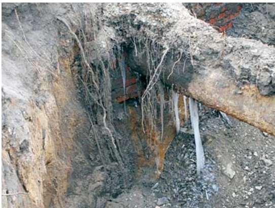
Рис. 7. Первичная стадия проседания грунта в зоне повреждения коллектора
