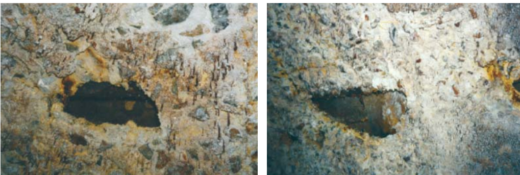
Рис. 2. Разрушение обделки и тюбинга канализационных тоннельных коллекторов в результате воздействия коррозии
