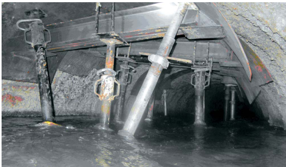
Рис. 14. Состояние конструкций тоннельного коллектора
