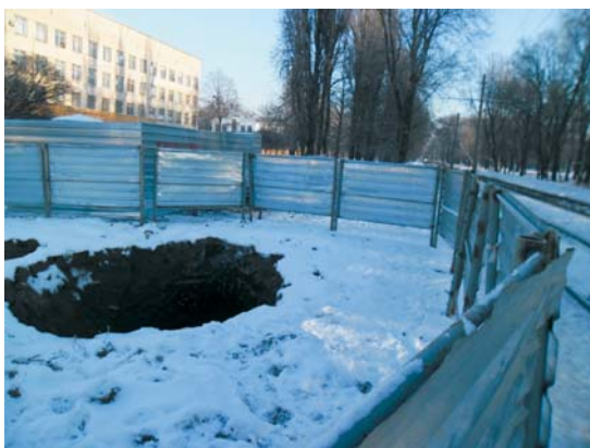
Рис. 8. Обрушения в зоне повреждения коллектора после засыпки грунтом первичного проседания грунта
