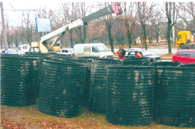
Рис. 3. Короткие полиэтиленовые трубы \varnothing 1200 мм для введения по методу «Inliner» в коллектор \varnothing 1500 мм
