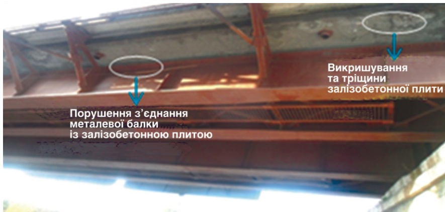
Рис. 1. Характерні пошкодження сталезалізобетонних мостів у процесі експлуатації
