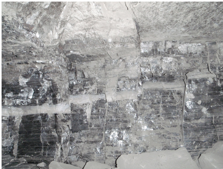
Рис. 2. Система техногенных трещин в 854-й лаве шахты «Западно-Донбасская»
