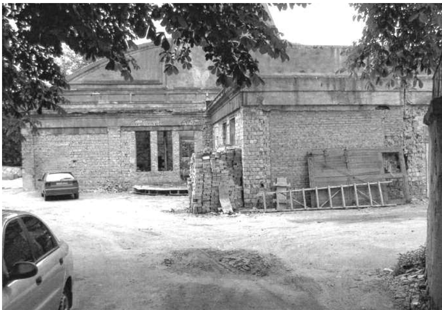
4. Будівля Інституту проблем сучасного мистецтва НАМ України до ревіталізації, головний вхід, фото 2007 р.
