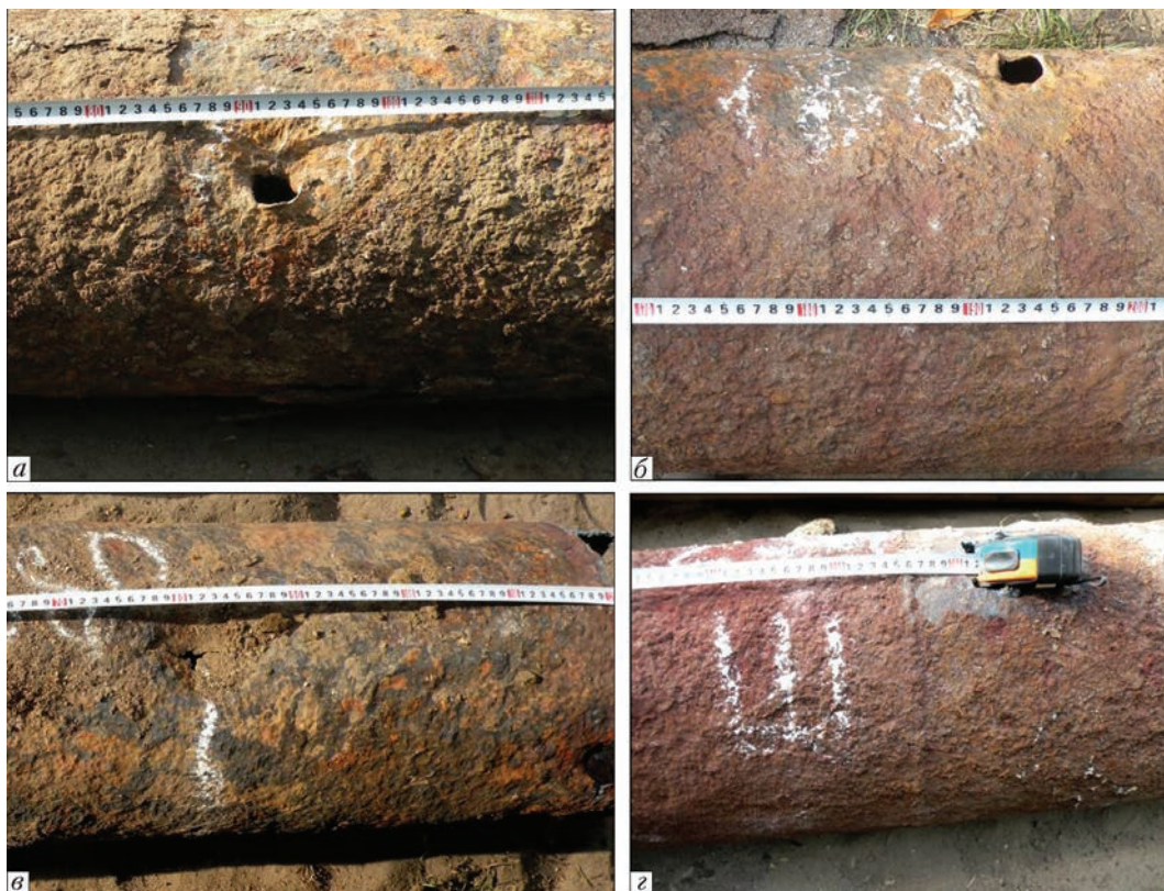
Рис. 14. Дефектные участки трубопровода на расстоянии 90 см (а), 195 (б), 5,8 м (в) и сварной шов на расстоянии 256 см (г)
