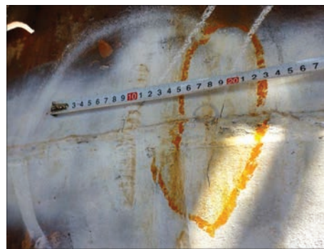
Рис. 3. Растрескивание монтажных кольцевых швов в верхней части регенератора в местах ремонтных подварок
