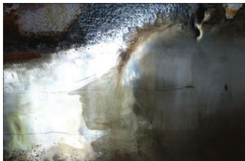
Рис. 1. Растрескивание по линии сплавления заводского сварного шва при укрупнении цагг обечайки диаметром 11000 мм
