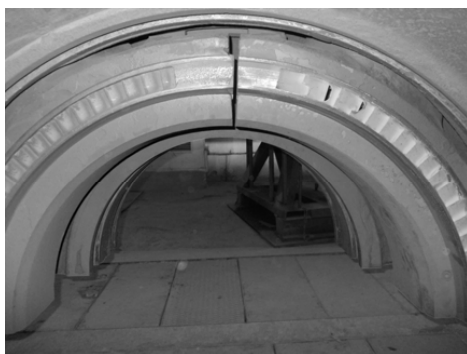
Рис. 3. Фотография направляющего аппарата первой ступени с повреждениями
