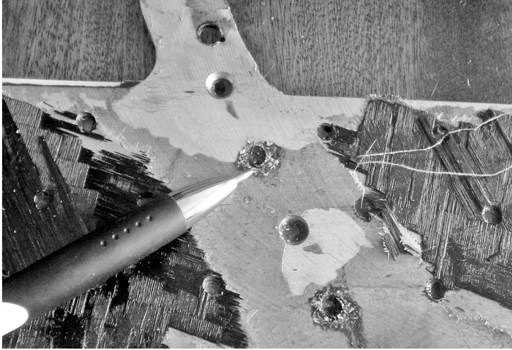
Рис. 3. Початок корозійного процесу в зоні непроклею на стиковій накладці кіля літака типу МіГ-29
