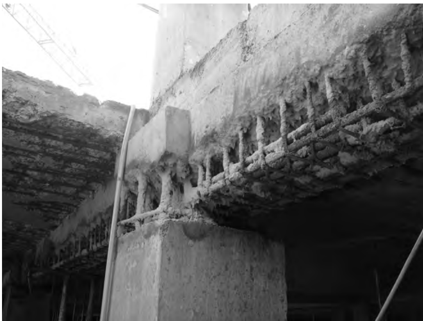
Рис. 3. Замерзлі бетонні, кам'яні та інші конструкції
