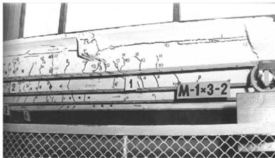
Фото 3. Характер тріщиноутворення у дослідній конструкції прогонової будови з діафрагмами
