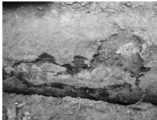
Рисунок 1 – Фотографія пошкодженої ділянки ізоляції нафтопроводу “Гнідинці – Глинсько-Розбишівська”
