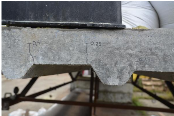
Рис. 4. Тріщини в плиті (КСБ-3).
