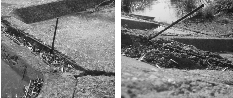
Рис. 3. Пошкодження, що несуть підвищений ризик нещасних випадків
