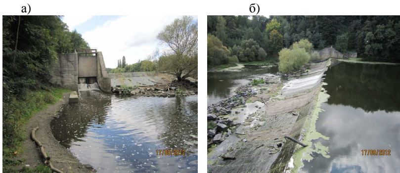
Фото. 2. Гребля в с. Станишівка Житомирської обл., а – вид з нижнього б'єфу; б – вид з верхнього б'єфу
