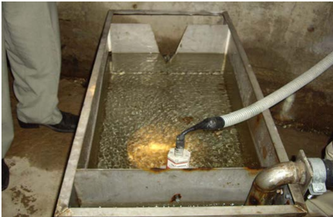
Рис. 9. Акумуляція фільтраційної води, вимірювання її витрати та відбір проб для аналізу процесів корозії бетону
