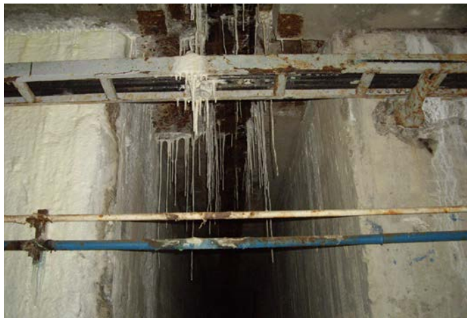
Рис. 8. Реальний стан деформаційного шва (видно продукти корозії бетону)
