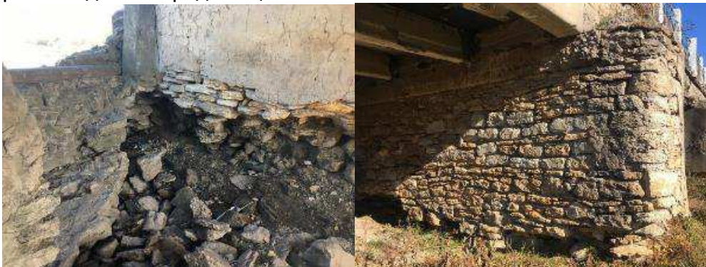
Рис. 3. Руйнація руслових опор мосту на границі коливань сезонної води. Поява тріщин в прогонових будовах моста
