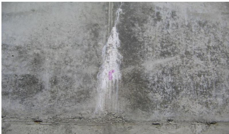
Рис. 2. Высолообразование на вертикальной поверхности стены подвала в зоне недоуплотнения бетона
