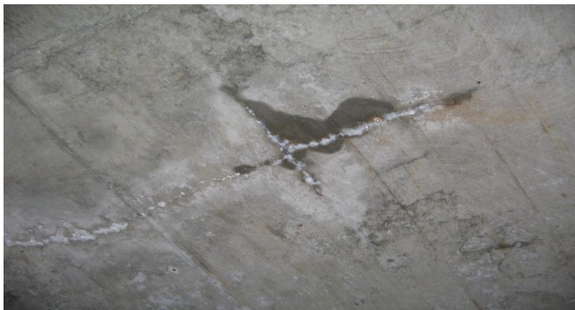
Рис. 1. Монолитная плита перекрытия подвала. Высолообразование и темные пятна от фильтрации воды через усадочные трещины
