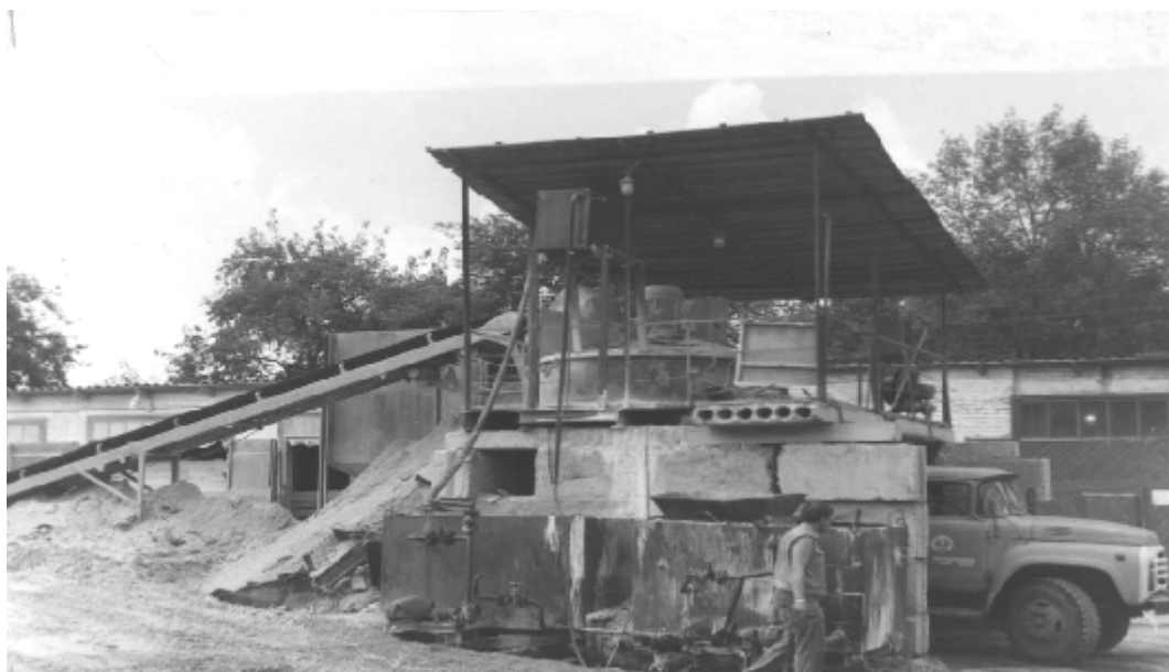
Рис.2. Сезонный БСУ по приготовлению шлакощелочного бетона в смесителе принудительного действия V = 1000л.
