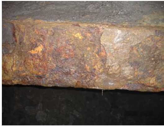
Рис. 1. Коррозионний износ футеровки нижней полки одного из ригелей
