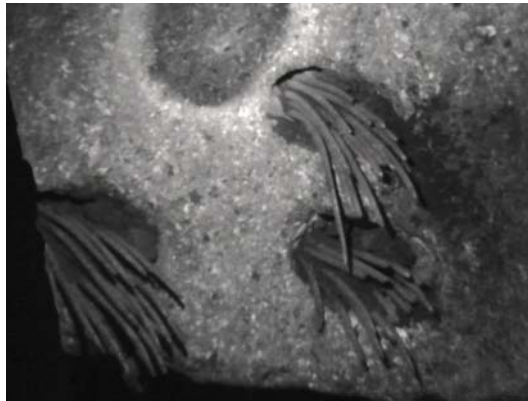
Рис. 2. Разрушение бетона нижней полки и разрыв пучковой арматуры ригеля Р8
