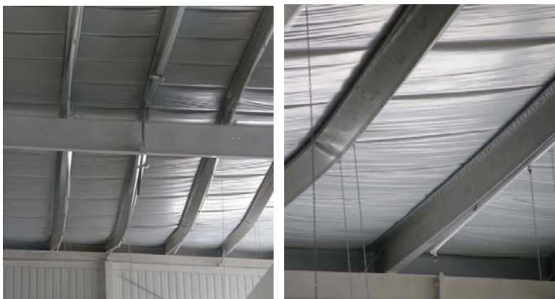
Рис. 1. Деформації конструкцій покриття під дією снігового навантаження
