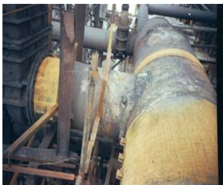
Рис.6. Поврежденный участок тройника коксового газа ПАО «Ясиновский коксохимзавод»
