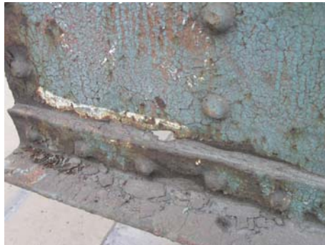
Рис. 4. Коррозионный износ конструкций
