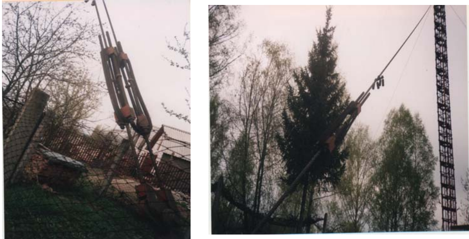
Рис. 2. Дефектные неподвижные траверсы стяжных муфт
