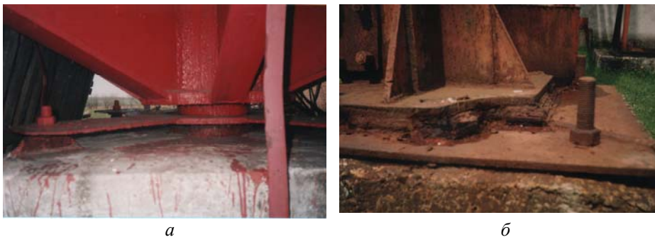
Рис. 3. Дефекты опорных узлов: а – мачты; б – башни
