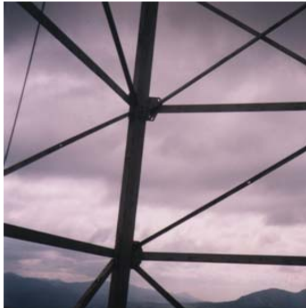
Рис. 4. Дефекты конструктивных элементов решетки башни
