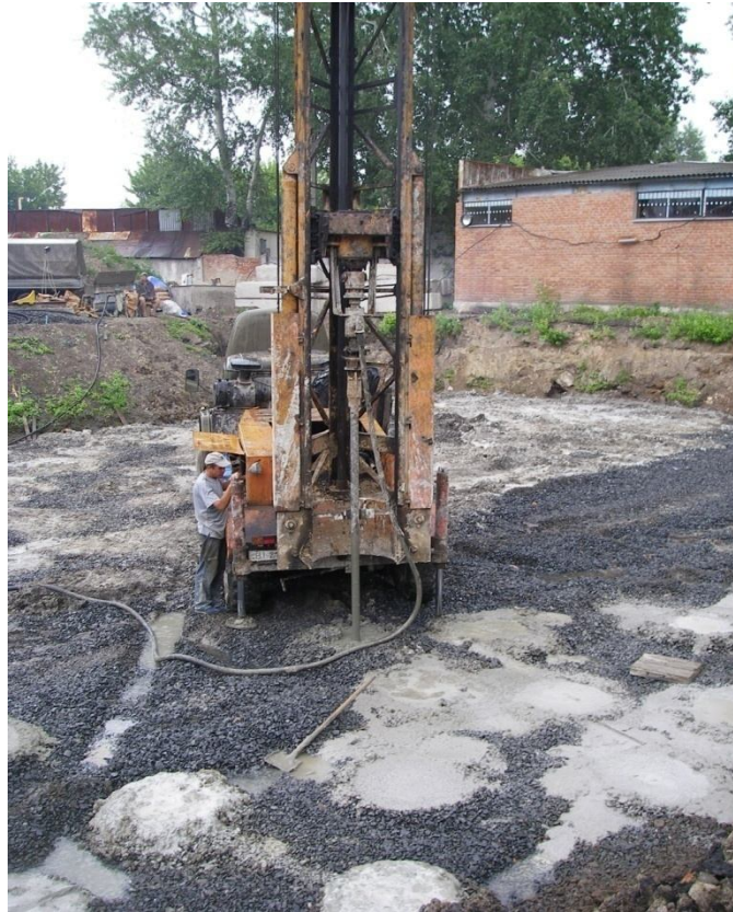
Рисунок 1 – Армування несучого шару основи вертикальними жорсткими ґрунтоцементними елементами, які виготовляють за бурозмішувальною технологією
