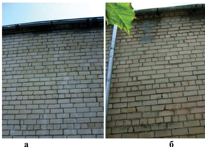
Рис. 6 – Сквозные трещины в кирпичных стенах пристройки фасадов: а) А – Н; б) Н – А
