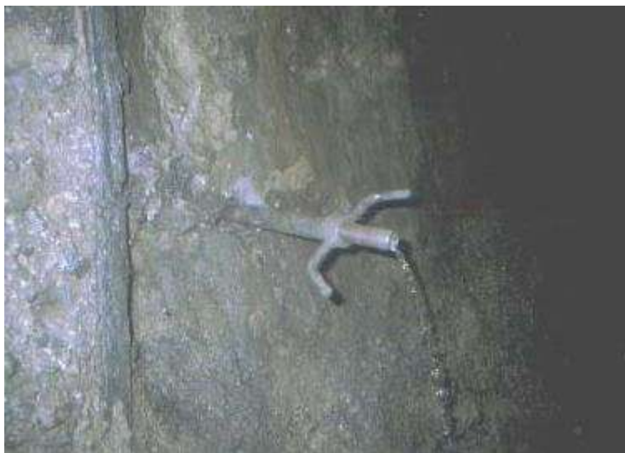
Рис. 1. Витікання води через ін'єктор, встановлений в шпарину, просвердлену в обробці тунелю до заобробкового простору
