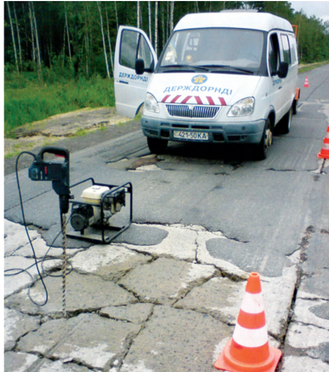
Рис. 4. Вигляд пошкодженої ділянки цементобетонного покриття на км 242+200 автомобільної дороги Київ – Ковель – Яготин
