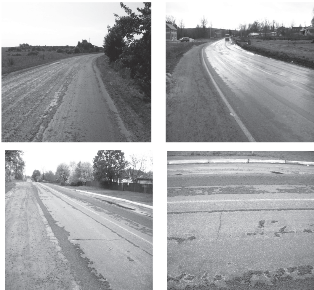
Рис. 1. Приклади незадовільного приживлення щебеню
