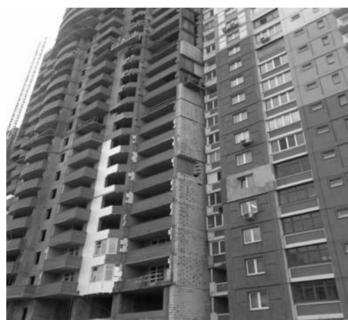
Рисунок 5. Ж.д. №5, масив «Троещина», 10 мкрн., г.Київ; монолітно-каркасна вставка - вид фасада з вулиці М.Цветаєвої
