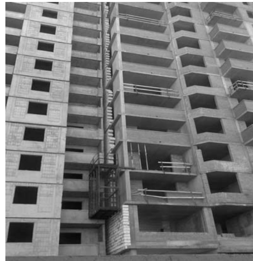
Рисунок 7. Ж.д. №10, массив «Троещина», 10мкрн., г.Киев; выполнение кладки торцевых стен из газобетонных блоков снаружи дома
