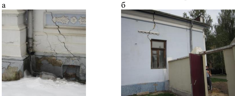
Рис. 4 (а и б) – дефекты наружных стен здания
