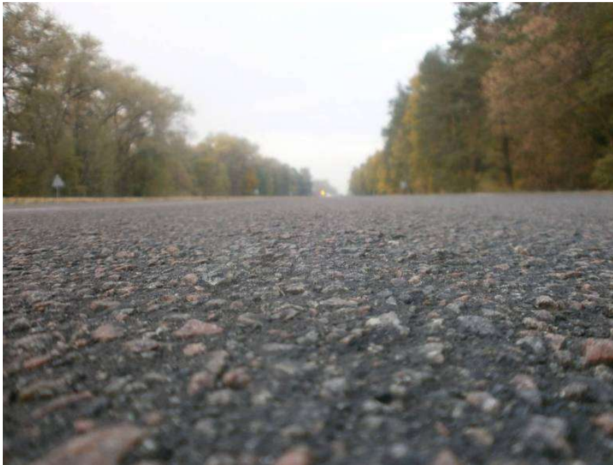
Рисунок 4 – Стан покриття з ЛЕМС на ділянці автомобільної дороги М-01 Київ – Чернігів – Нові Яриловичі, км 101, через 3 роки після застосування технології гарячого ресайклінгу з верхнім шаром з ЛЕМС
