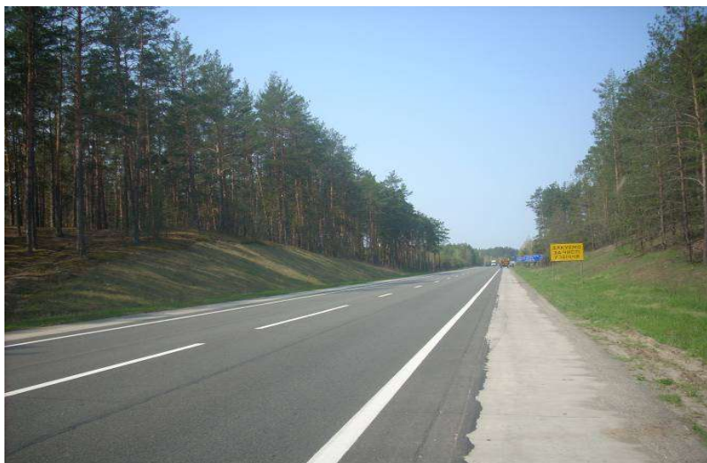
Рисунок 3 – Стан покриття з ЛЕМС на ділянці автомобільної дороги М-07 Київ – Ковель – Ягодин, км 79+400 – км 86+500 через 7 років після влаштування захисного шару на цементобетонному покритті.
