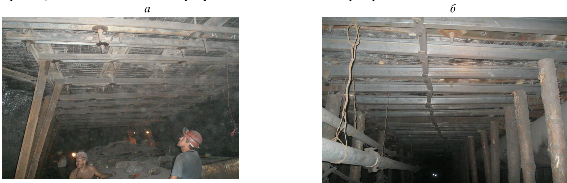
Рис. 2. Состояние монтажного ходка пятой северной лавы уклона пласта m_4^0 : а – при проведении; б - после проведения
