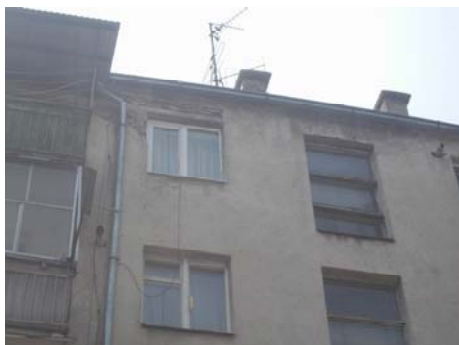
Рис. 2. Відколи цегли зовнішніх стін житлового будинку
