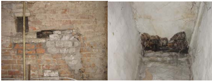
Рис. 4. Пошкодження конструкцій будівлі вокзалу
