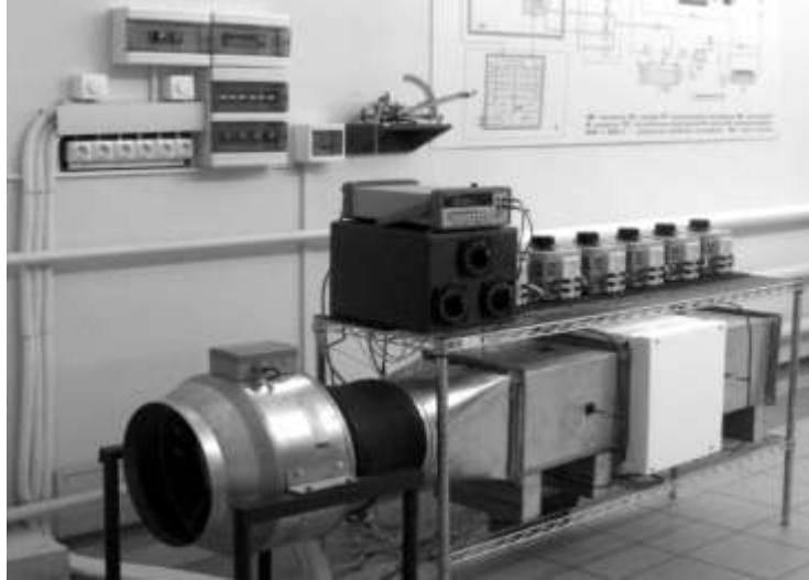
Рисунок 1 – Общий вид установки
