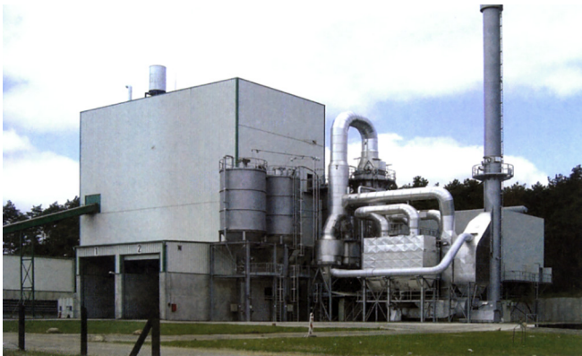
Рис. 2. Електростанція в Вільмерсдорфі (Німеччина) на відходах деревини
