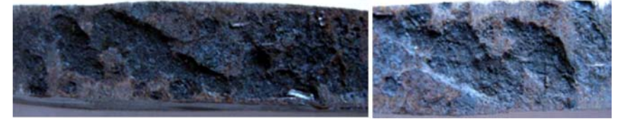
Рис. 1. Внутрішня поверхня експлуатованої труби викидної лінії свердловини
