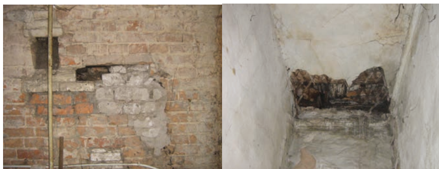
Рис. 4 Пошкодження конструкцій будівлі вокзалу
