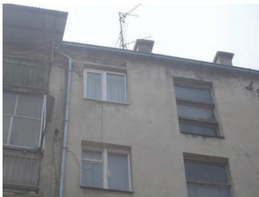
Рис. 2 Відколи цегли зовнішніх стін житлового будинку
