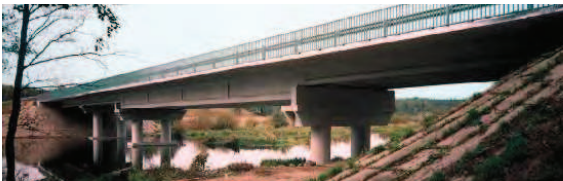
Рис. 4. Загальний вид розширеного залізобетонною накладною плитою моста через р. Уж біля м. Коростеня Житомирської області на км. 148+997 автодороги Київ-Ковель-Ягодин
