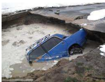
Рисунок 2 – Провали ґрунту в результаті підповерхневих витоків з підземних теплових мереж безканальної прокладки
